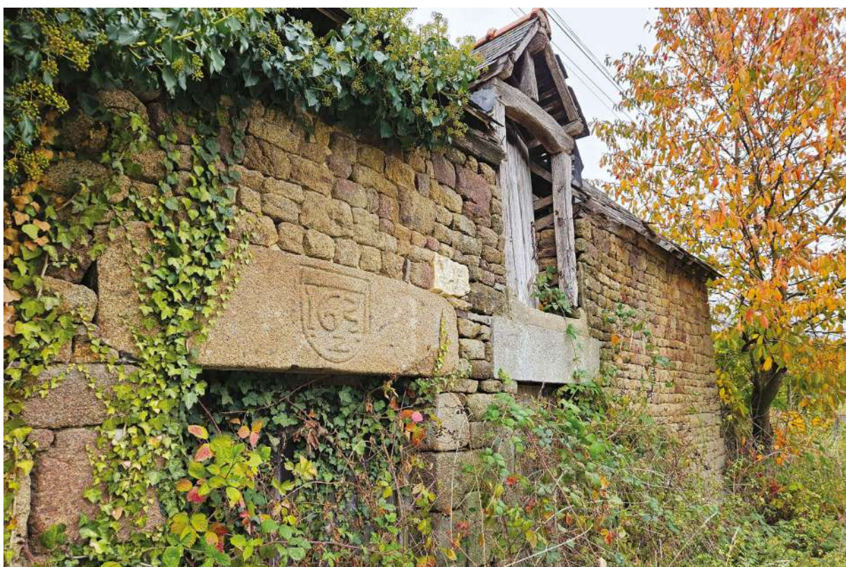
Dans un écart, une habitation millésimée à l'abandon et en mauvais état sanitaire © TC_CMDB
